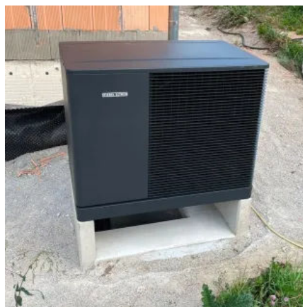
Anwendungsbeispiel Fertigfundament mit aufgestellter Wärmepumpe von Stiebel Eltron
