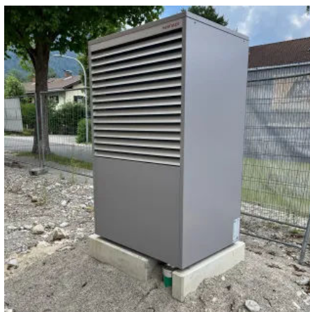
Anwendungsbeispiel Fertigfundament mit aufgestellter Weishaupt Wärmepumpe
