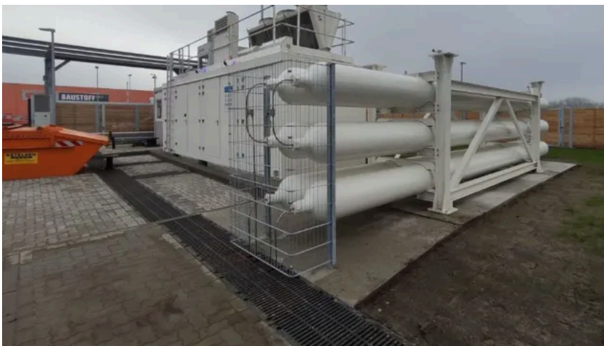
Versorgungslösung auch für Wasserstofftankstellen. Die offenen Abdeckungen stellen die erforderliche Belüftung der Leitungen sicher.
