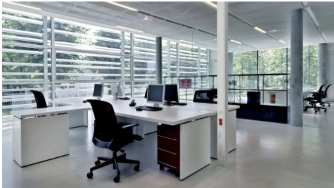
Boden-Decken-Installationssäulen sind frei im Raum positionierbar. Ein flexibler Schlauch zur Decke speist die Säule mit Daten- und Stromkabeln.
