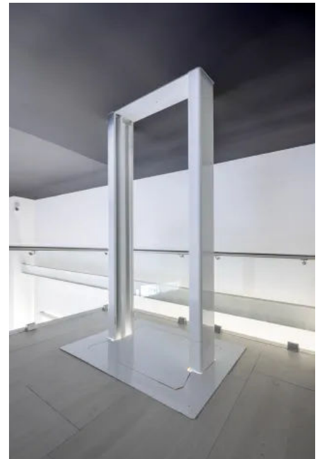
Über selbsttragende Schienen fährt der Luma unauffällig zwischen zwei Etagen. Die Kabel sind verdeckt integriert.
