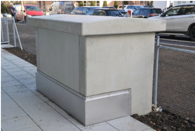
Lüftungseinhausung nach Maßvorgabe
