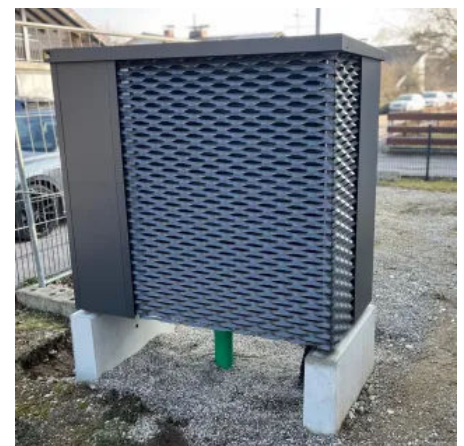
Anwendungsbeispiel Fertigfundament mit aufgestellter Wärmepumpe
