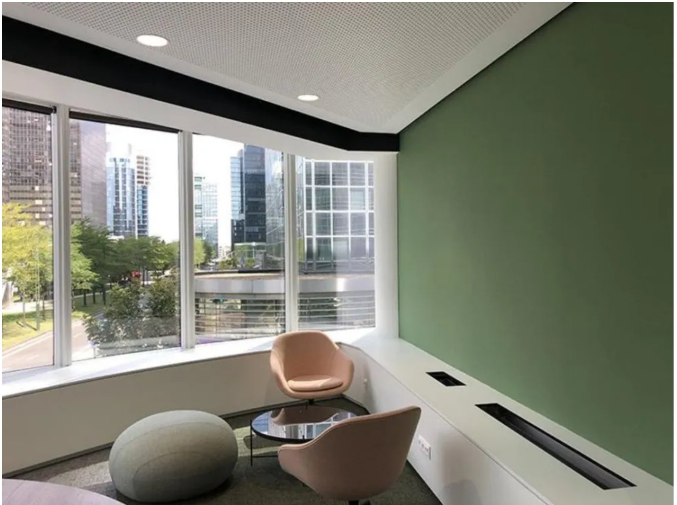
Gelochte Heiz- Kühldecke mit Singlerohr
