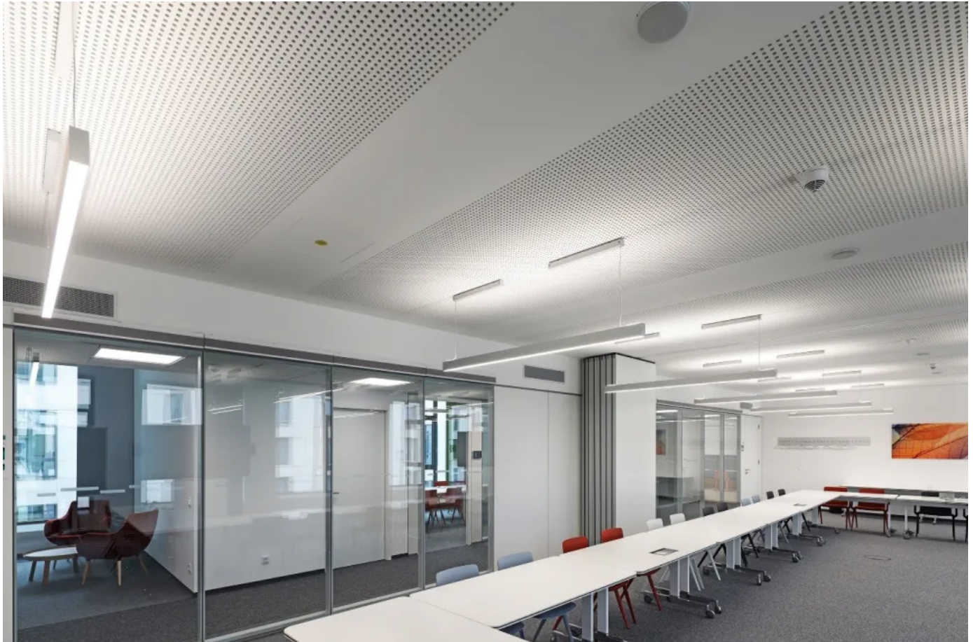
AOK Bayern | gelochte Heiz-Kühldecke
