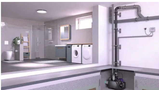
Hebeanlage Aqualift L im Schacht aufgestellt unterhalb der Rückstauenebene
