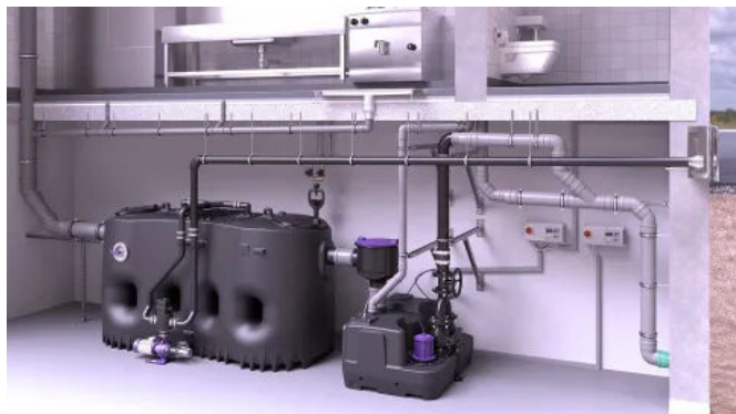
Hebeanlage Aqualift XL mit 450-Liter-Behälter hinter einem großen Fettscheider NS 15 eingebaut
