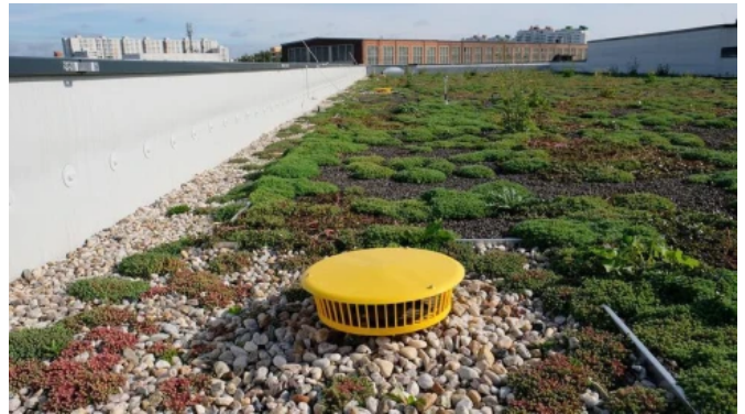
Die Anschlussbauteile des Retentionsdaches sind zur vereinfachten Revision in einem Kiesbett platziert.
