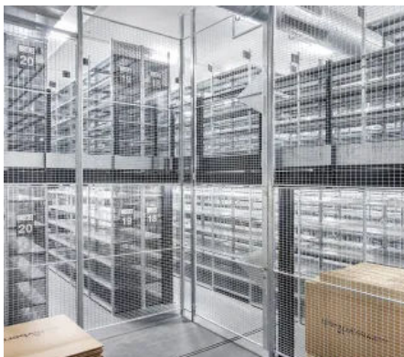
Zweigeschossiges Lager aus MultiSafe Gittertrennwänden
