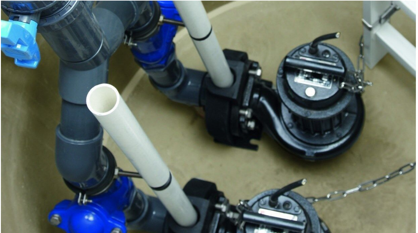
Pumpstationen – sichere Entwässerung zum Schutz gegen Rückstau
