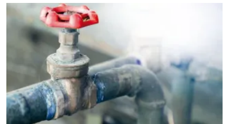
Korrosion in Rohrnetzen verursacht oft juristische Auseinandersetzungen
