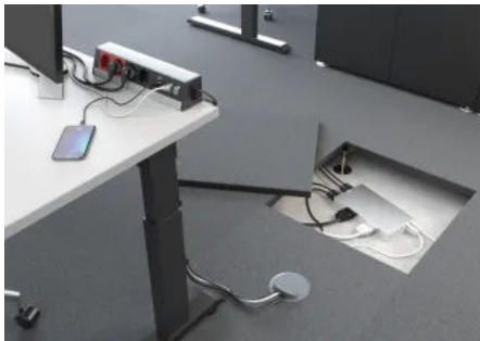
Energieverteilung im Doppelboden mit Leitungsauslass zum Arbeitsplatz
