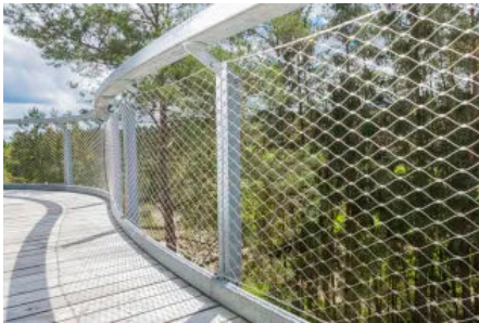
Geländernetze: X-TEND® Edelstahl-Seilnetze als Geländerfüllung (© Baldauf & Baldauf Fotografie)
