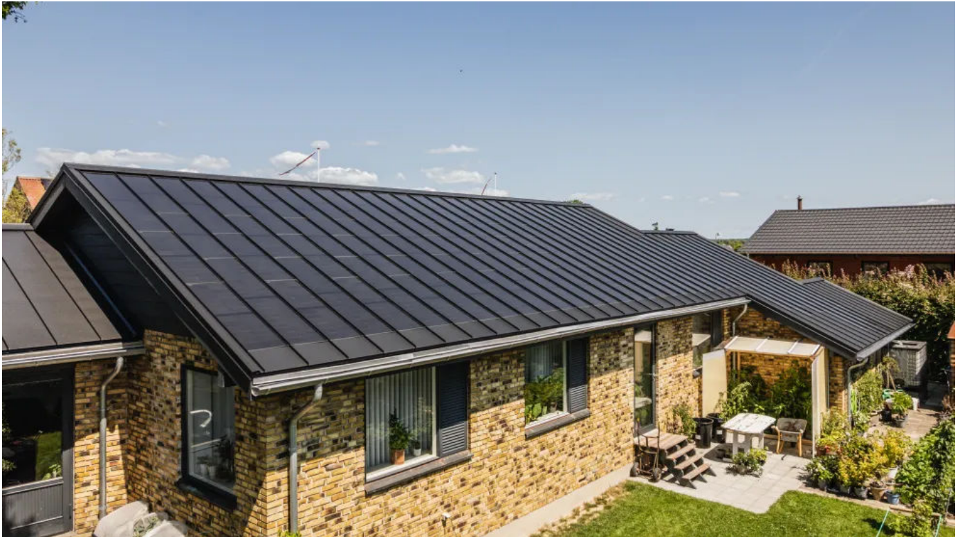
Land: Dänemark, Ort: Tølløse, Objekt: Wohnhaus. Installation: 2024; Leistung: 13,31 kWp
