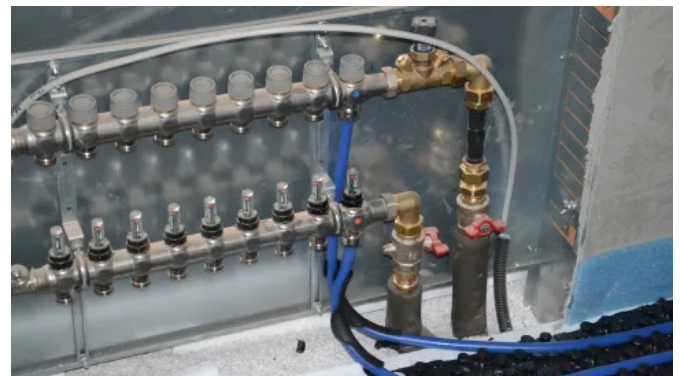
BLANKE PERMATOP Heizkreisverteiler
