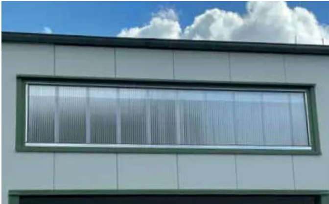
Aurora Set basic plus – eingesetzt in einer Industriehalle
