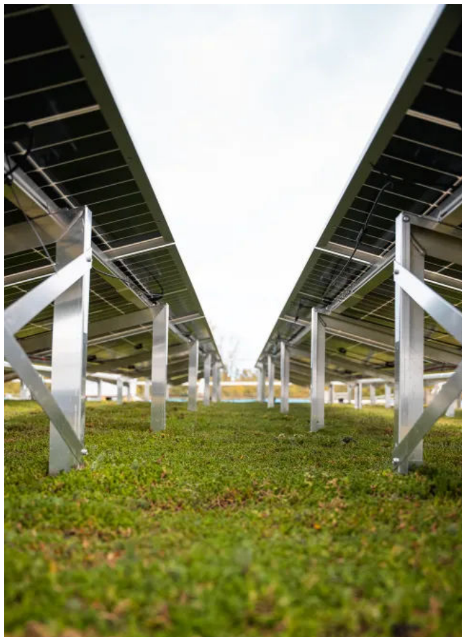
Ein Solargründach in der Praxis auf einem Gebäude der Universität Enschede © Optigrün
