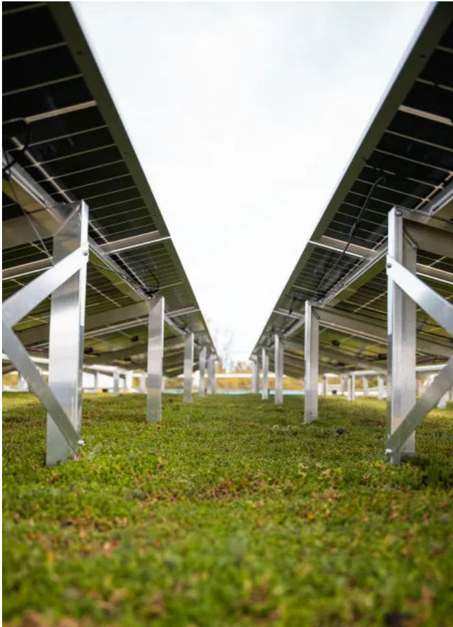
Ein Solargründach in der Praxis auf einem Gebäude der Universität Enschede © Optigrün
