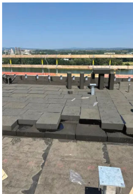
Foamglas T3+ wird auf dem Flachdach des Timber Peak als Gefälledämmung mit 1,1\% Neigung eingesetzt. Die Ausbildung des Gefälles dient der Ableitung von Niederschlagswasser und dem Schutz der Dachkonstruktion vor Feuchteintrag. (© KOCH Bedachungen GmbH)
