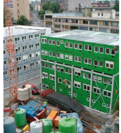
Versorgung einer Containeranlage mit 144 Büro- und Tagesunterkuntscontainern
