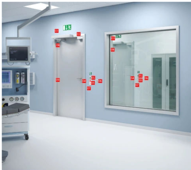
Fluchtwegsicherung SafeRoute: Schleusenbereich zwischen zwei OP-Saal-Türen
