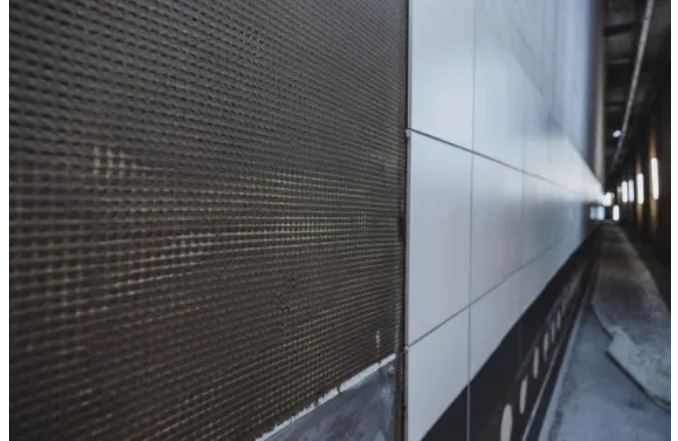
Bei der Sanierung wurden die Wände in den Ein- und Ausfahrtsbereichen der ersten Röhre mit neuen Keramikfliesen verkleidet.
