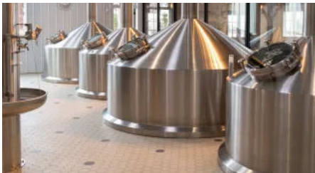
Argelith Industriefliesen in einer Brauerei
