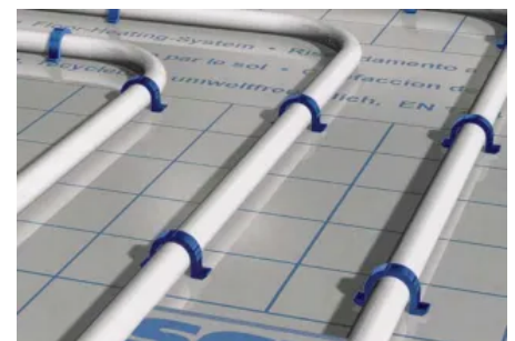
Auch bei Richtungsänderungen sind die Rohre sicher fixiert.
