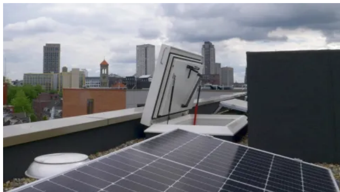
ThermoTop als Wartungszugang zu Solarmodulen
