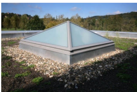
Flachdach Fenster FE Pyramide Mehrzweckturnhalle in Hersbrück
