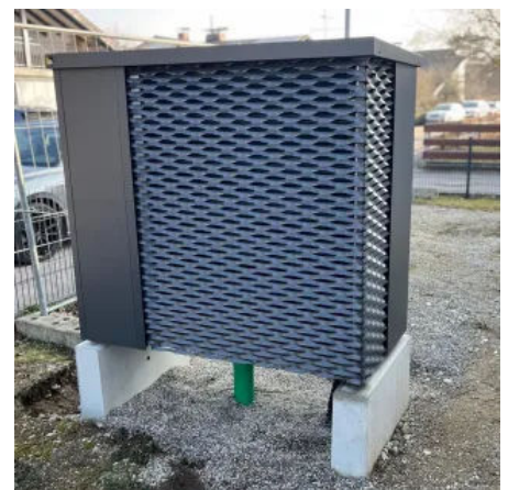
Anwendungsbeispiel Fertigfundament mit aufgestellter Wärmepumpe
