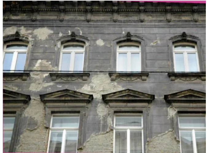
Vor der Sanierung mit erheblichen Schäden an der Fassade
