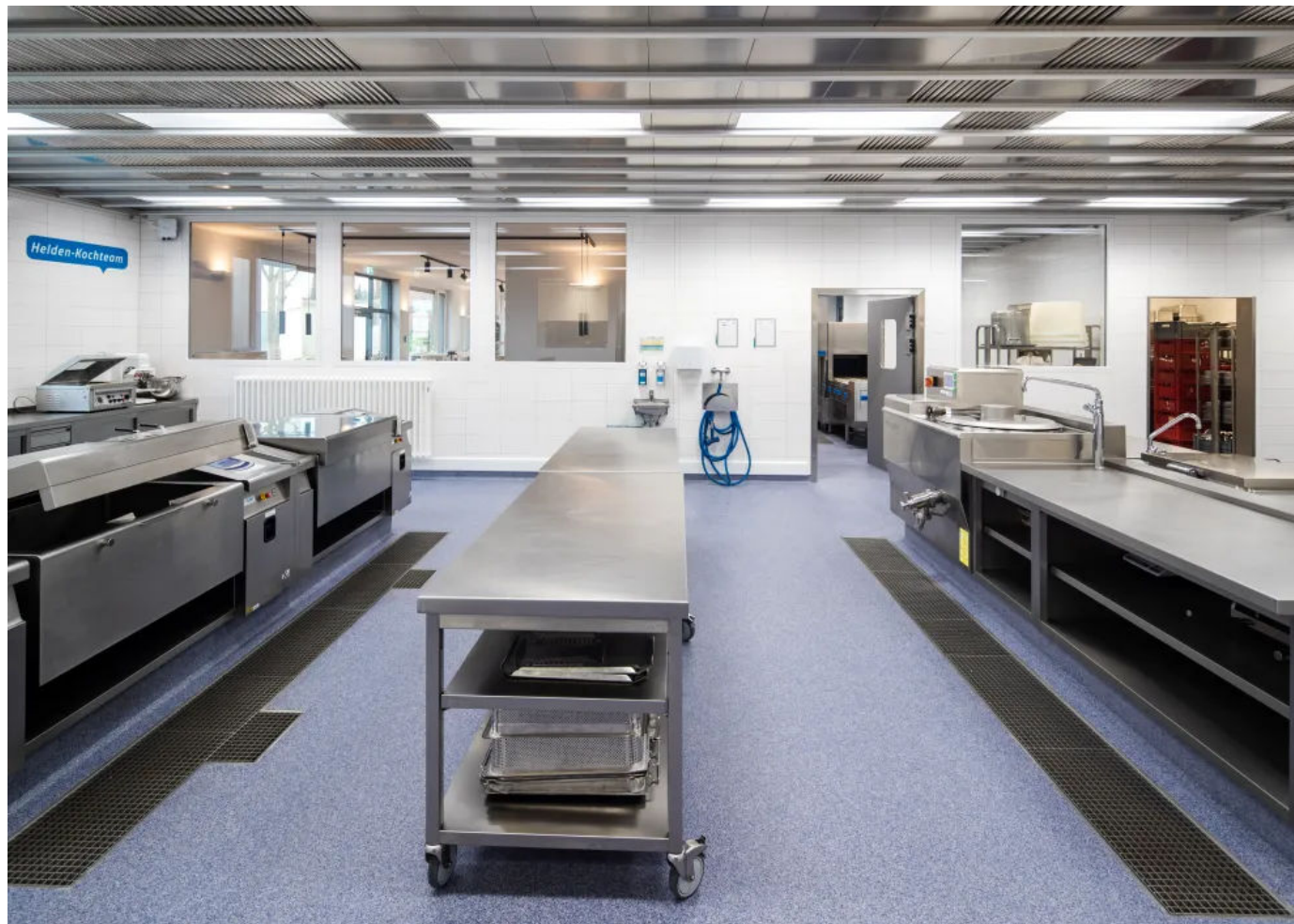
Bodenrinnen in einer Großküche (© Jan Meier, Bremen)
