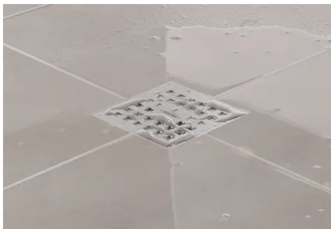
BLANKE DISK-CUBE verbaut
