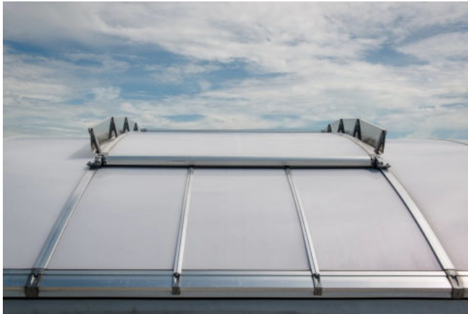
LAMILUX Lichtband B Passivhaus LINNENBRINK Maschinenbau GmbH in Warburg
