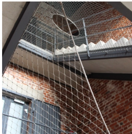
X-Tend im Treppenhaus
