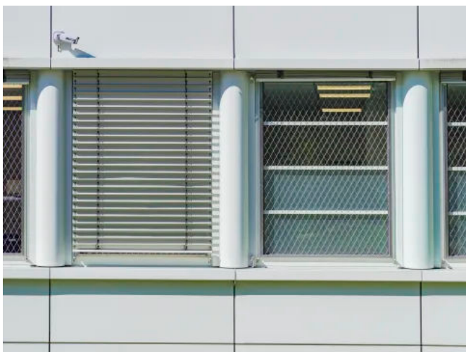
Fenstersicherung an der TK Gesundheit Hallbergmoos (© Baldauf & Baldauf Fotografie)
