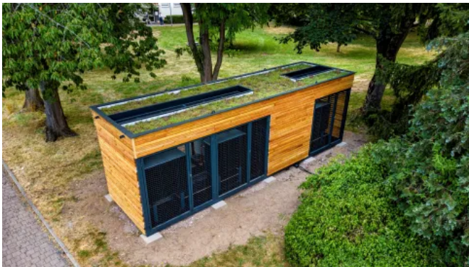
Die fertige Heizungszentrale aus einer Hand
