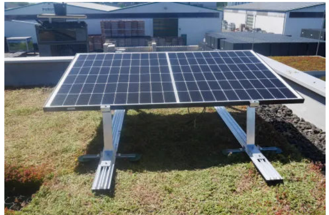
Das Gründach mit Solarmodul wird zum Solar-Grün-Dach.
