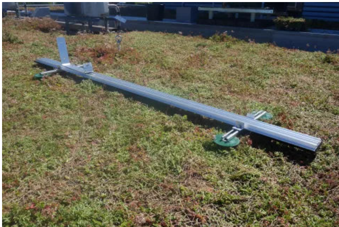
Befestigungsschiene verankert im Gründach
