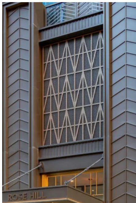
Wetterschutzgitter im Rose Hill Wohngebäude (© Lester Ali)
