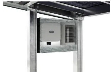
Die Solar-Verkabelung ist vormontiert und in den integrierten Schaltschrank gelegt.
