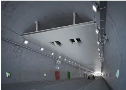
Nachträglich montierte Entrauchungsdecke
