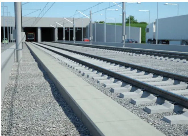
Abdeckung von Flucht- und Rettungswegen
