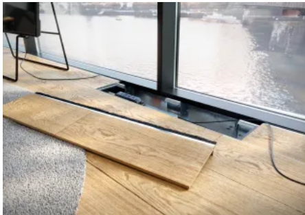
Fertig montierte OKB-Kanäle lassen sich auch nachträglich problemlos öffnen und mit Steckdosen, Daten- und Multimediaanschlüssen bestücken.
