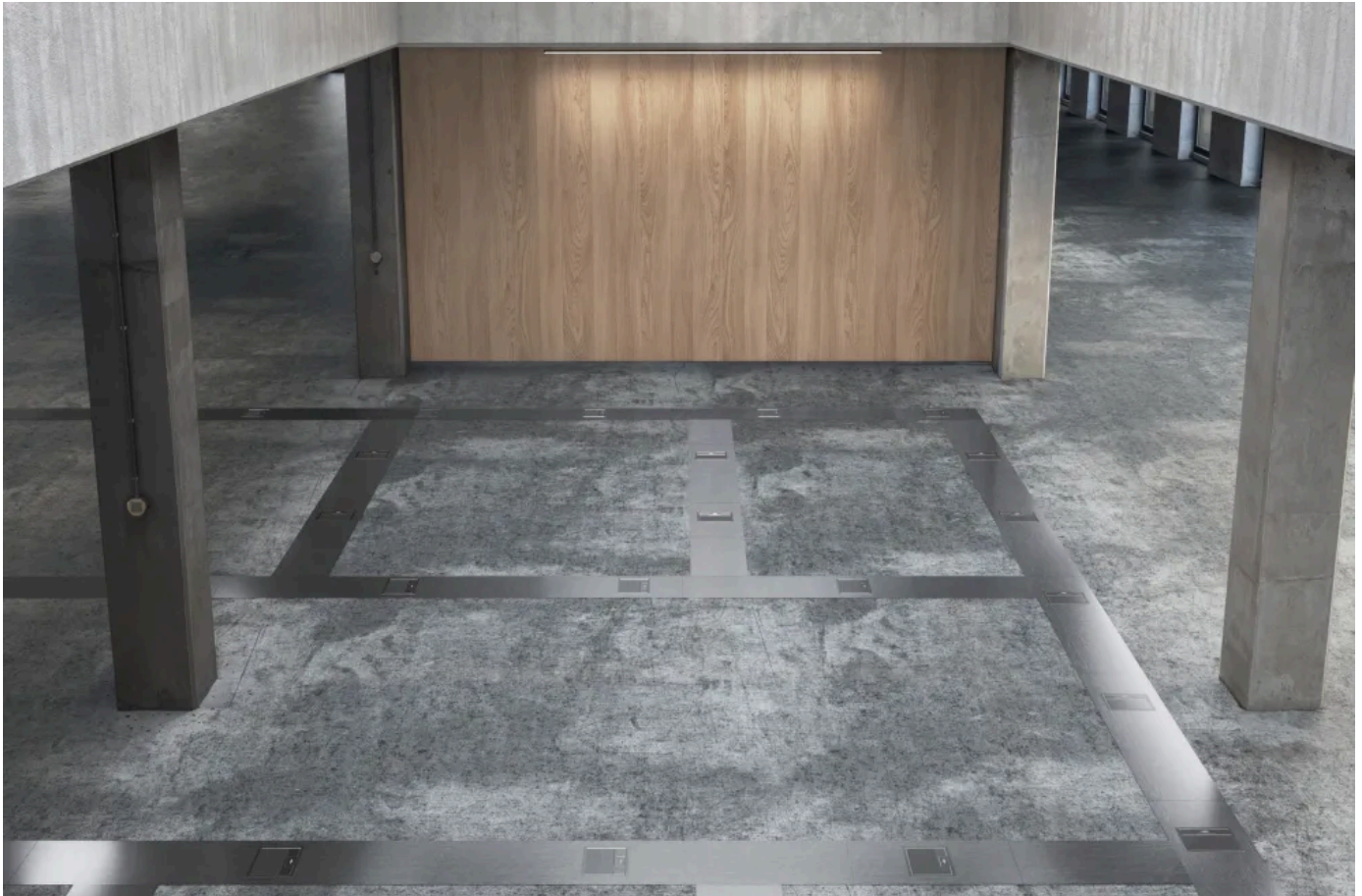
Das offene Kanalsystem OKA ist flexibel anpassbar: Die bodenbündigen Kanaldeckel sind auch bei fertig verlegtem Bodenbelag revisionierbar.
