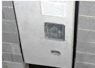
Öffnungen, Putztürchen und Anschlüsse sind bereits eingebaut. ATMOS Fertigschornstein
