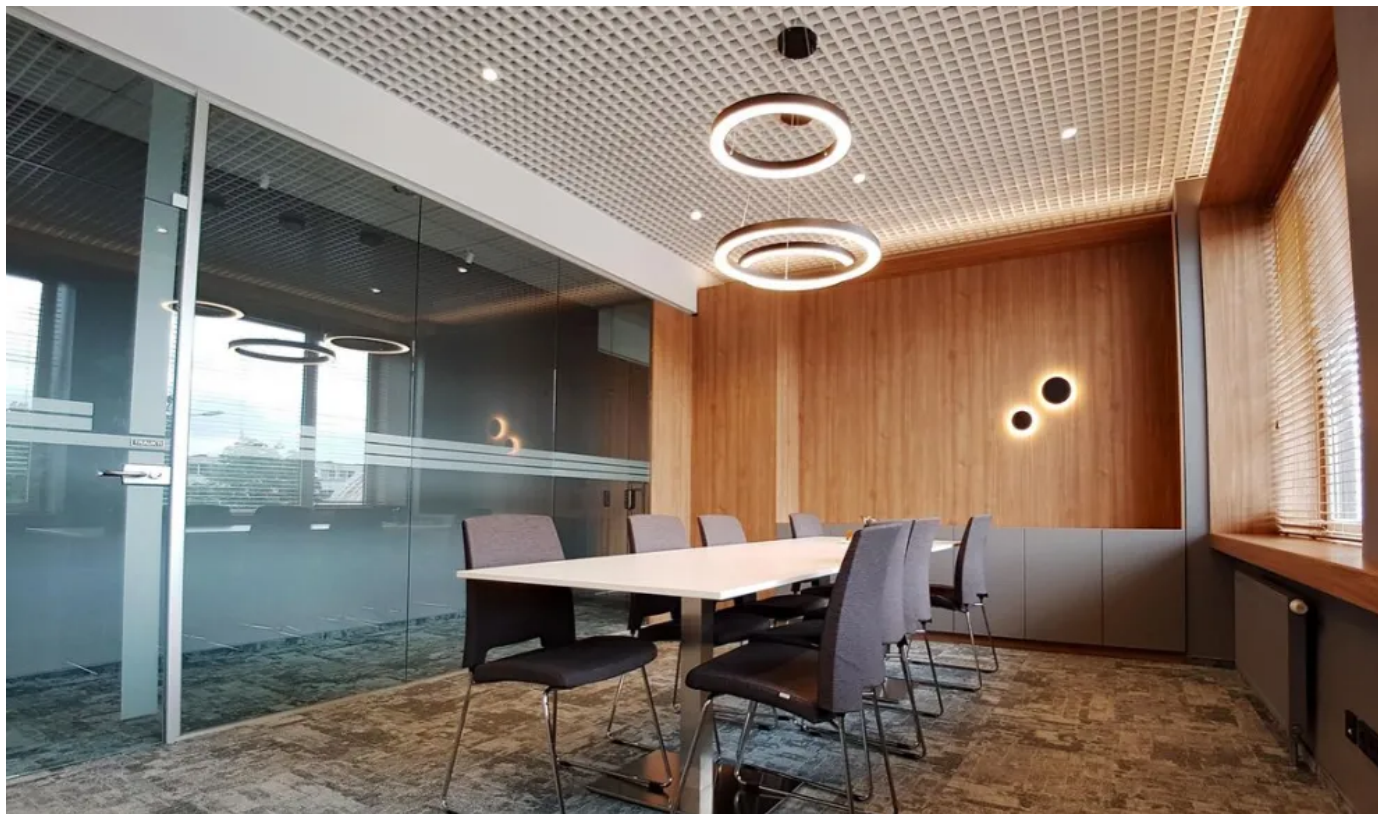
Tenko Baltic | Offene Deckenkonstruktion mit ungefärbten, weißen Kapillarrohrmatten
