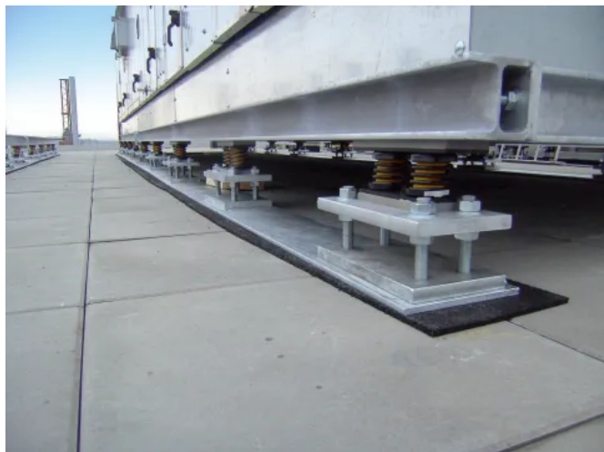
Lagerung eines Klimagerätes
