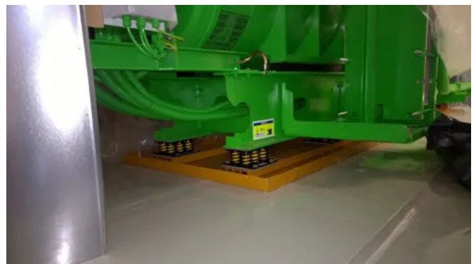
Entkopplung BHKW Jenbacher
