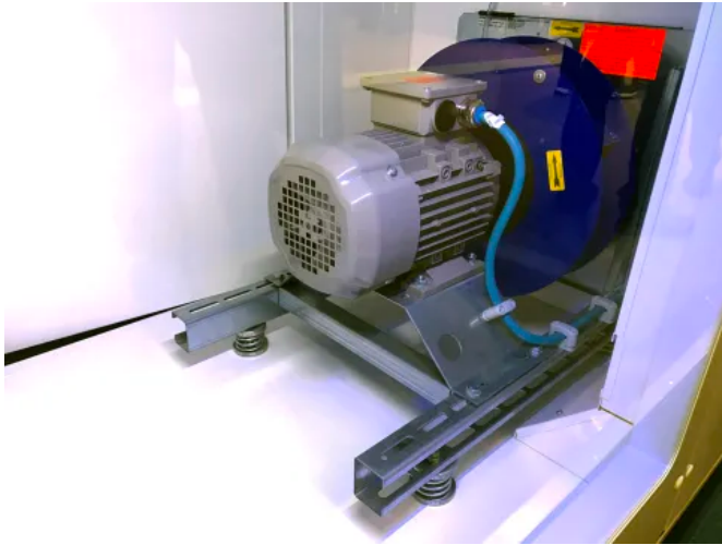
Lagerung eines Ventilators mit Isotop MSN
