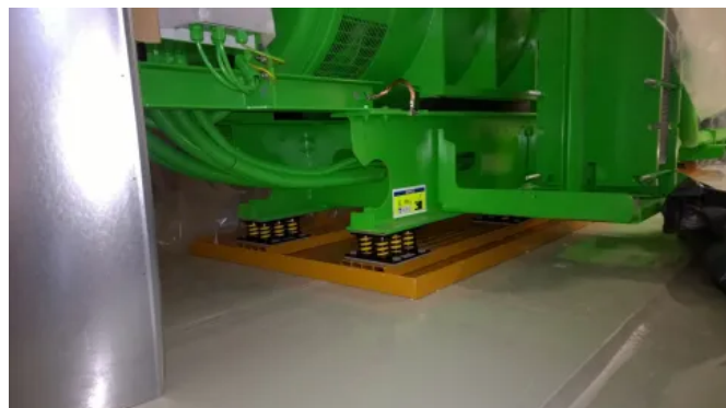
Entkopplung BHKW Jenbacher
