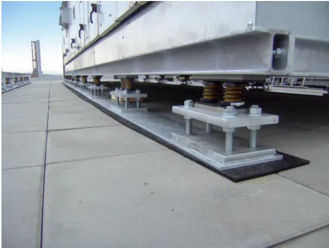
Lagerung eines Klimagerätes
