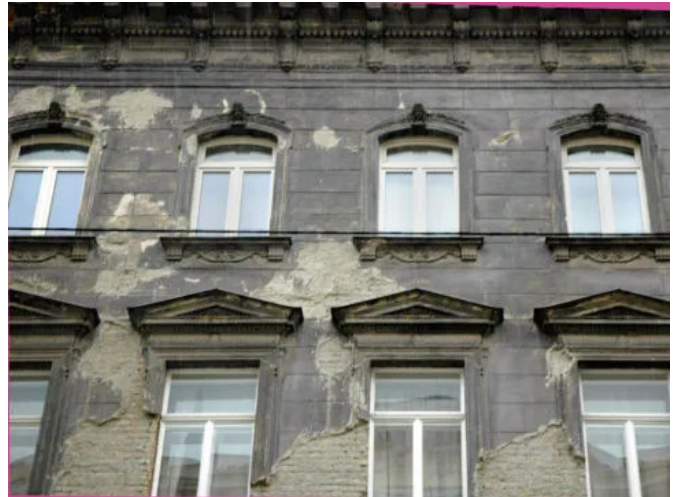
Vor der Sanierung mir erheblichen Schäden an der Fassade
