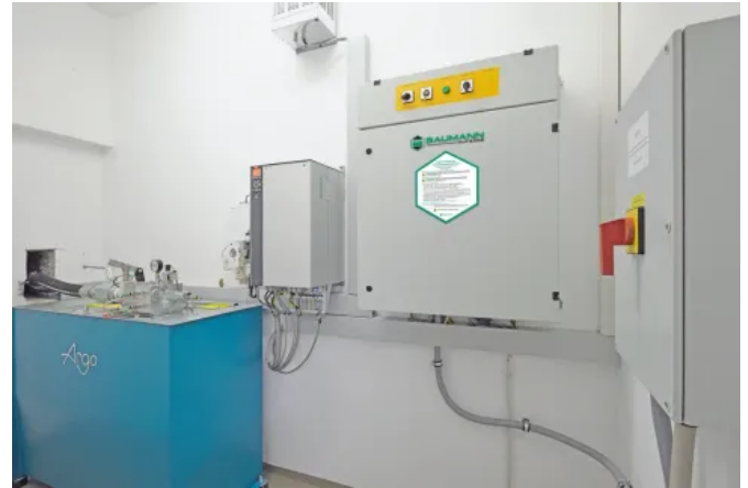
Antriebs- und Steuerungstechnik sind im Maschinenraum untergebracht.
