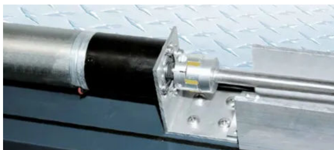
Antriebsmotor Vertikalschiebefenster bei geöffneter Abdeckung
