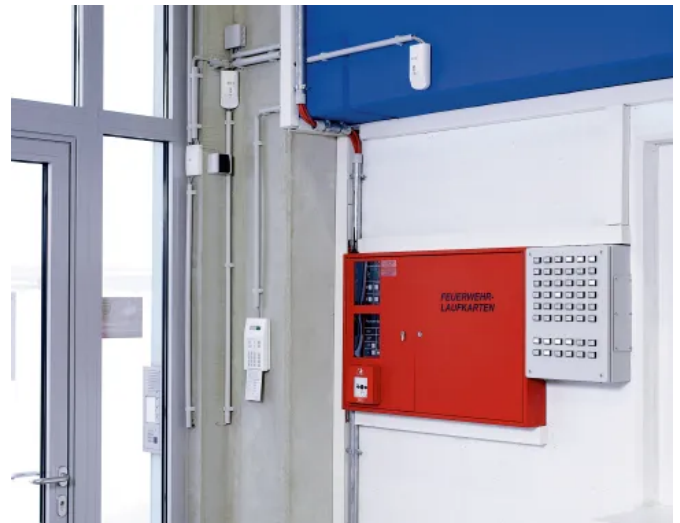
Sicherheit am Personaleingang ©TELENOT
