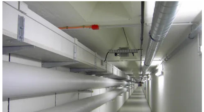
Baulicher Brandschutz für Elektroinstallationen
