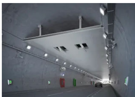
Nachträglich montierte Entrauchungsdecke
