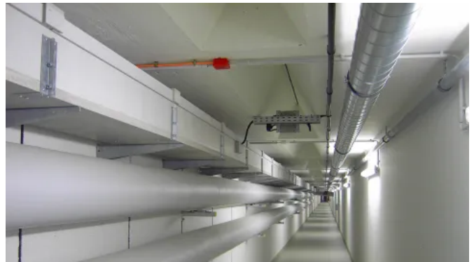
Baulicher Brandschutz für Elektroinstallationen
