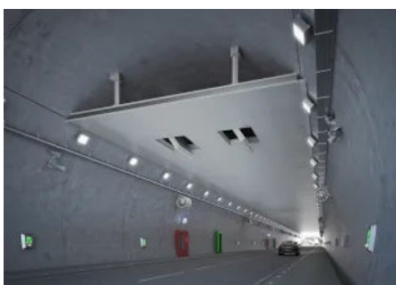
Nachträglich montierte Entrauchungsdecke
