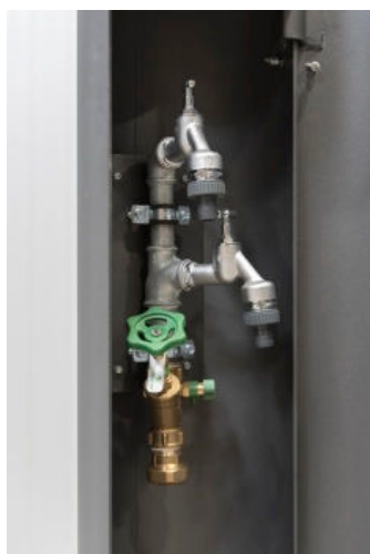
Wasseranschluss mit zwei Entnahmestellen
