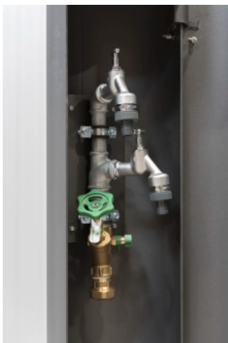
Wasseranschluss mit zwei Entnahmestellen
